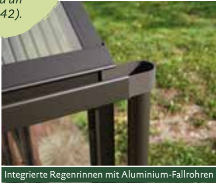
Integrierte Regenrinnen mit Aluminium-Fallrohren
