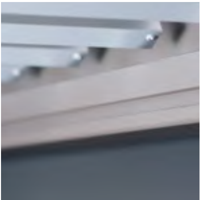
03 Vorbereitung für LED-Beleuchtung (Kanal mit Abdeckung)
